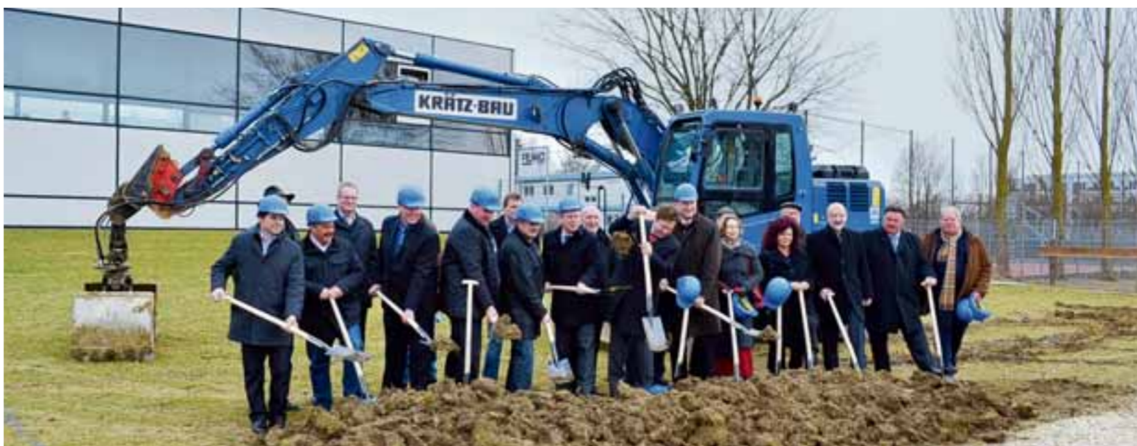
Gestern Mittag wurde mit den Bauarbeiten für die neue Biomasse-Hackschnitzel-Heizungsanlage für Berufs- und Realschule, die Turn- und Schwimmhalle sowie für das bestehende Schülerheim und den Erweiterungsbau begonnen. Foto: Salvamoser
