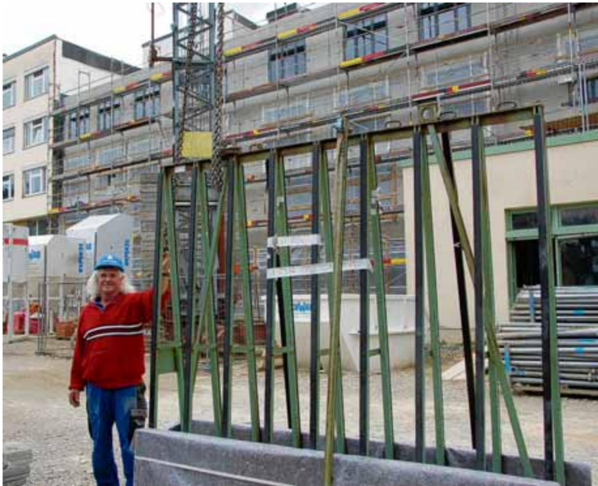
Es läuft rund auf der Baustelle der Wertinger Kreisklinik. Polier Ludwig Meyer von der Firma Krätz hatte gestern Morgen alles im Griff. Im Dezember sollen Patienten in den neuen Bettentrakt (Hintergrund) einziehen können. Fotos: Berthold VEH
