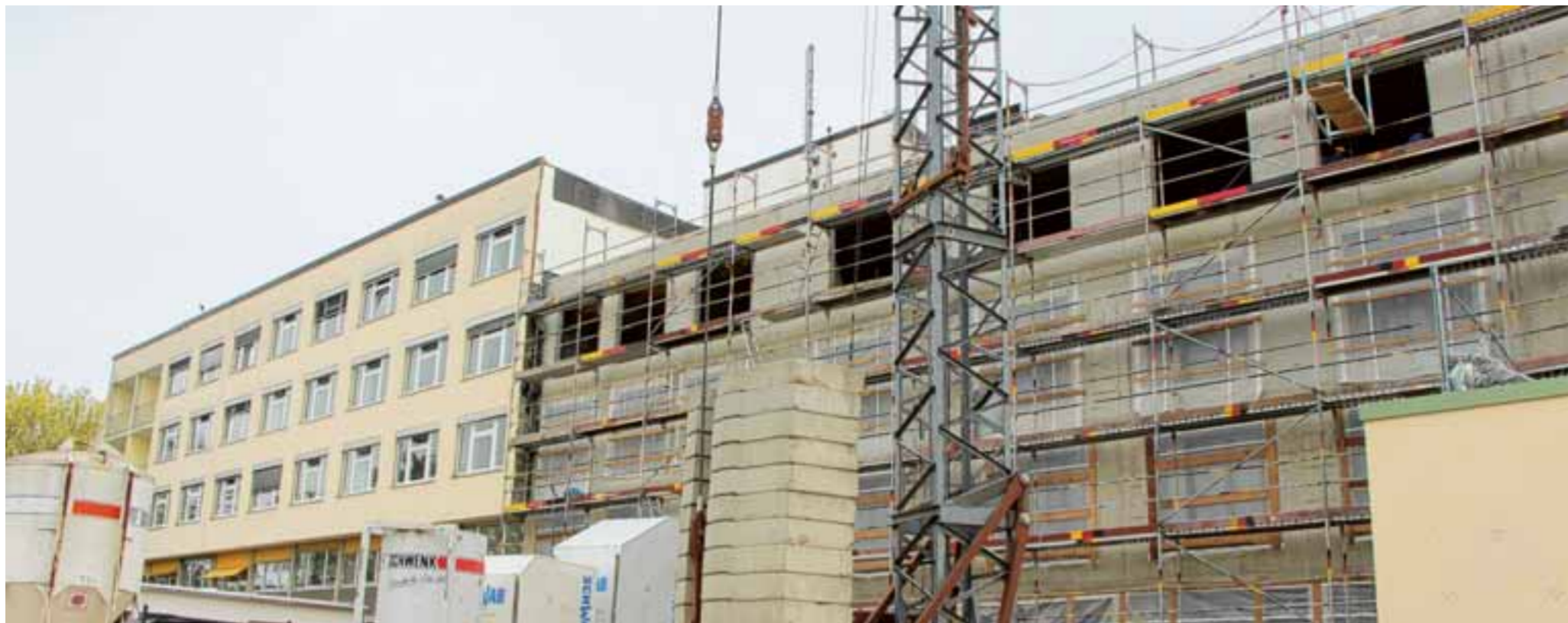
Großbaustelle Wertinger Krankenhaus. Dort, wo alter Trakt (links) und neuer Anbau (Südostseite) zusammenstoßen, herrscht in diesen Tagen und Wochen hektische Betriebsamkeit. Die Handwerker haben alle Hände voll zu tun, die Patienten stört der dadurch entstehende Baulärm aber wenig.
